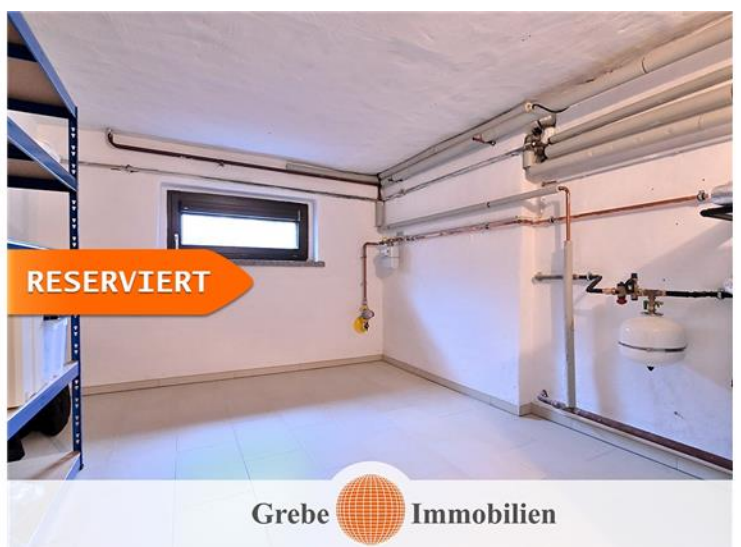
Heizungsraum im UG
